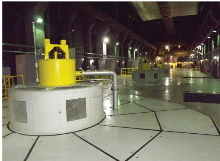
Empreendimento conta com três unidades de geração e potência máxima de 130 megawatts
