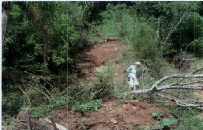
Gleba E-092: ruptura de talude
