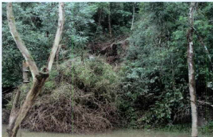
Gleba D-152: Ruptura de talude
