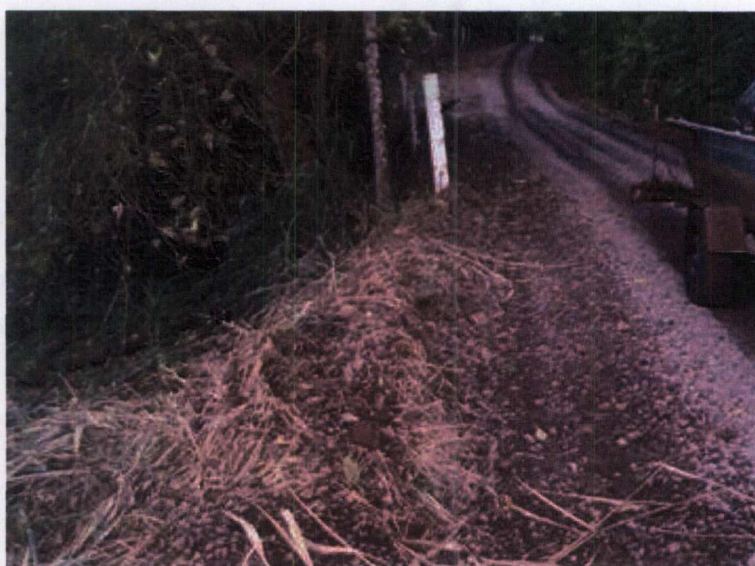
Gleba D-088: cerca danificada
