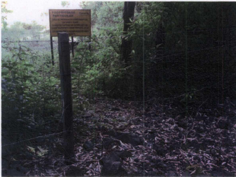
Gleba D-005: Cerca danificada
