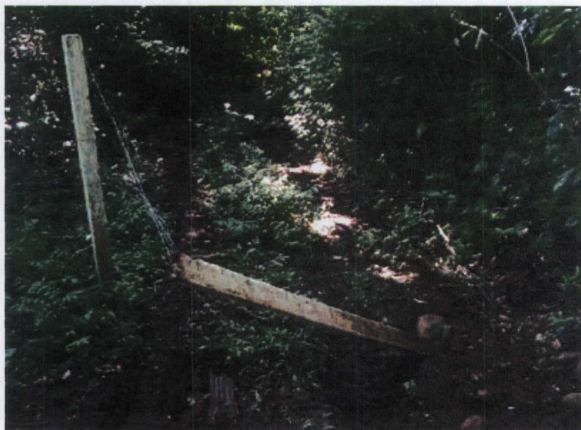
Gleba E-026: verificado dano em 5,0 m de cerca
