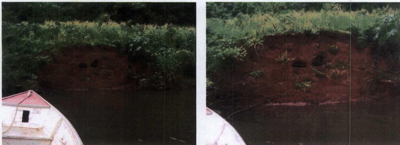
Gleba E-040: deslizamento de talude
