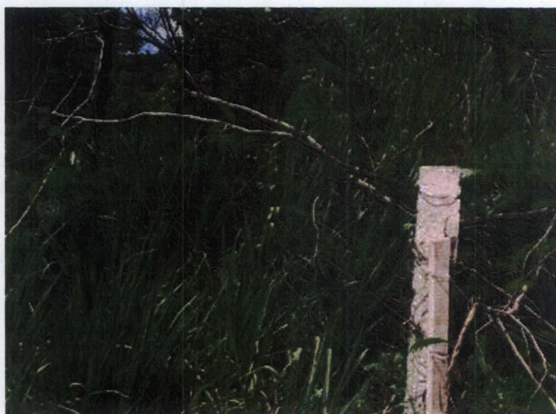
Cercas que necessitam de manutenções/limpezas.
