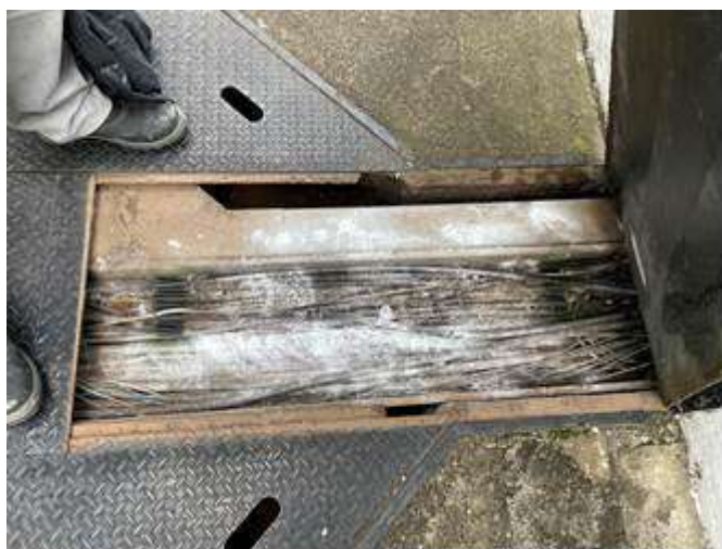
Nicho de cabos de comunicação.
